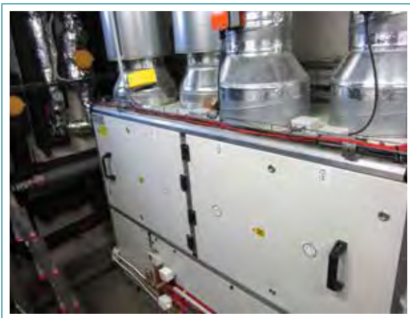
Obr. 6.11 Větrací jednotka umístěná v prostorách chodby
