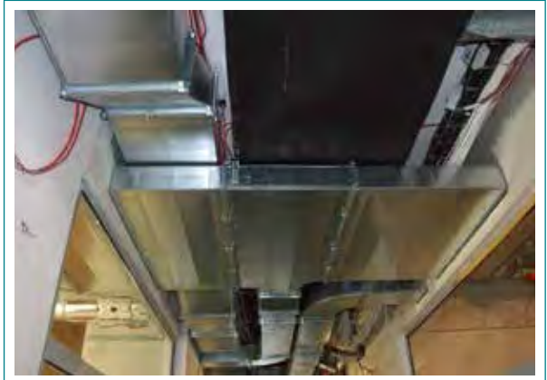
Obr. 6.6 Vedení vzduchovodů v chodbě (foto: prof. Tywoniak)
