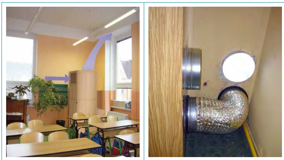
Obr. 6.14 Učebna vybavená lokální větrací jednotkou s bezpotrubním přívodem vzduchu, vpravo realizace otvorů ve fasádě (zdroj: Atrea)
