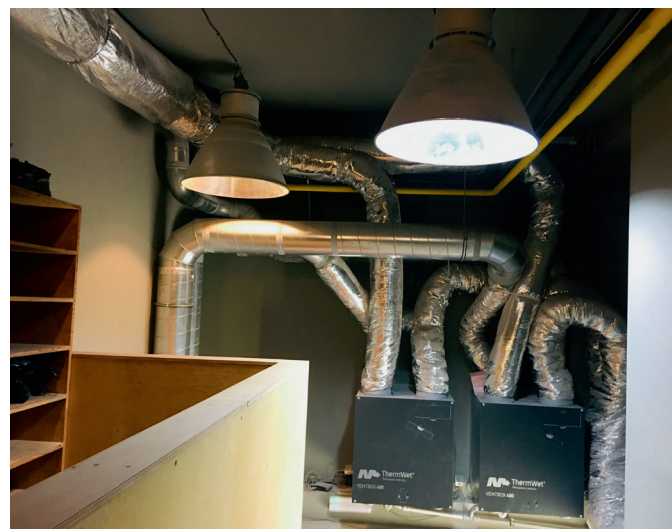
Obr. 15 Nevhodné použití ohebných hadic jako páteřních vzduchovodů (foto: autor)
